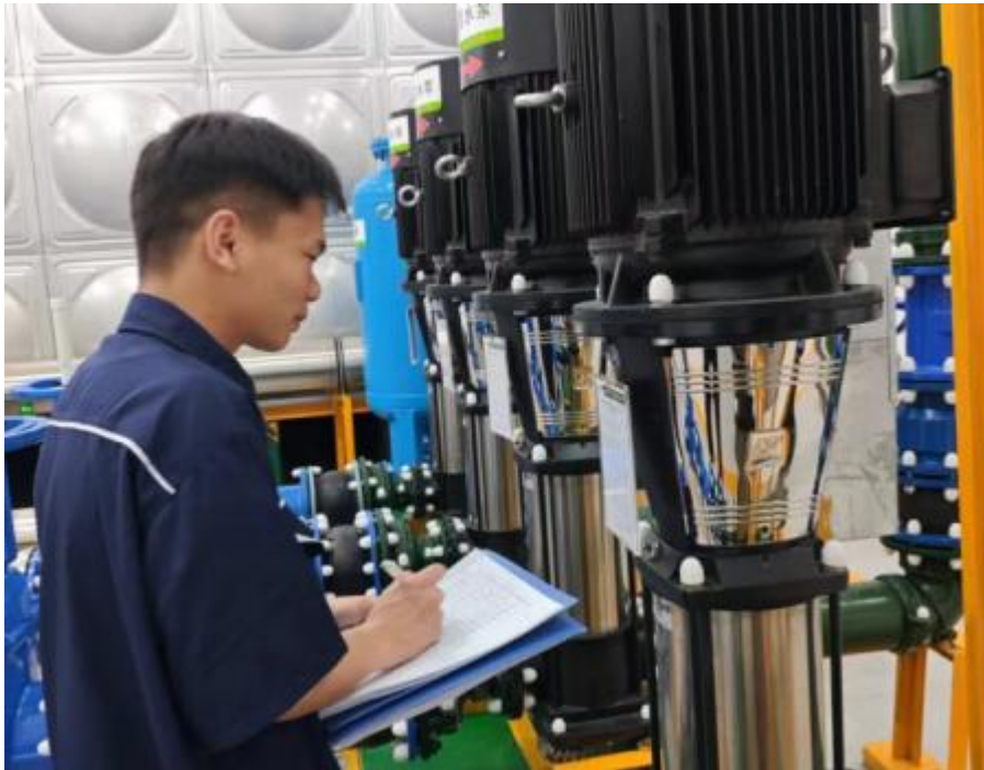
工程师傅对北校区水泵房进行巡检
