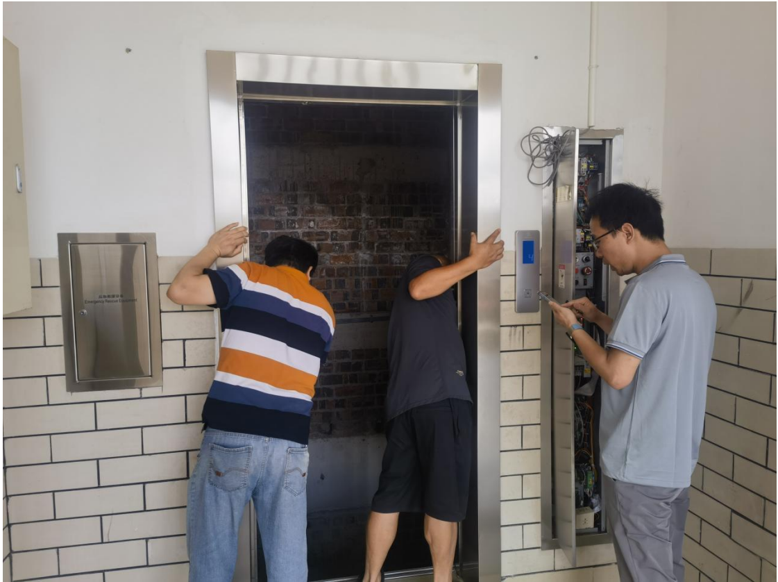
勘察北校区T1电梯故障情况
