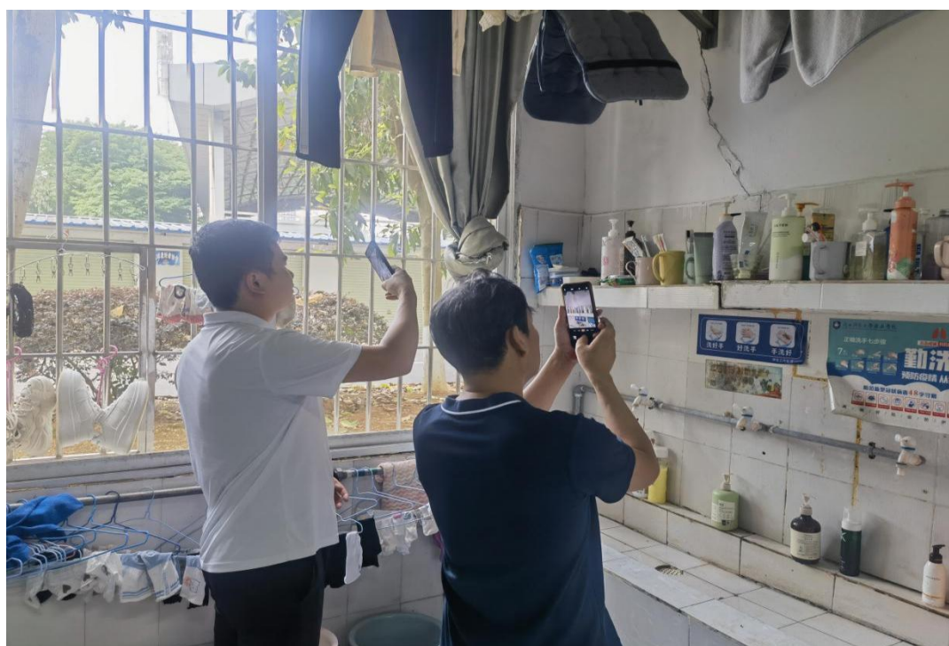
勘察第6栋宿舍楼一楼填充墙下沉情况
