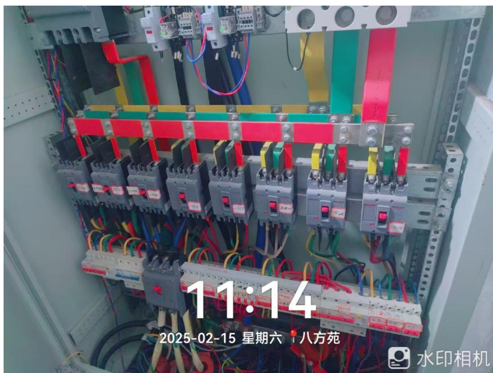
工作人员对电路进行安全检查
