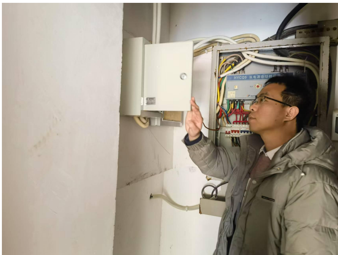
对教学楼配电箱进行检查
