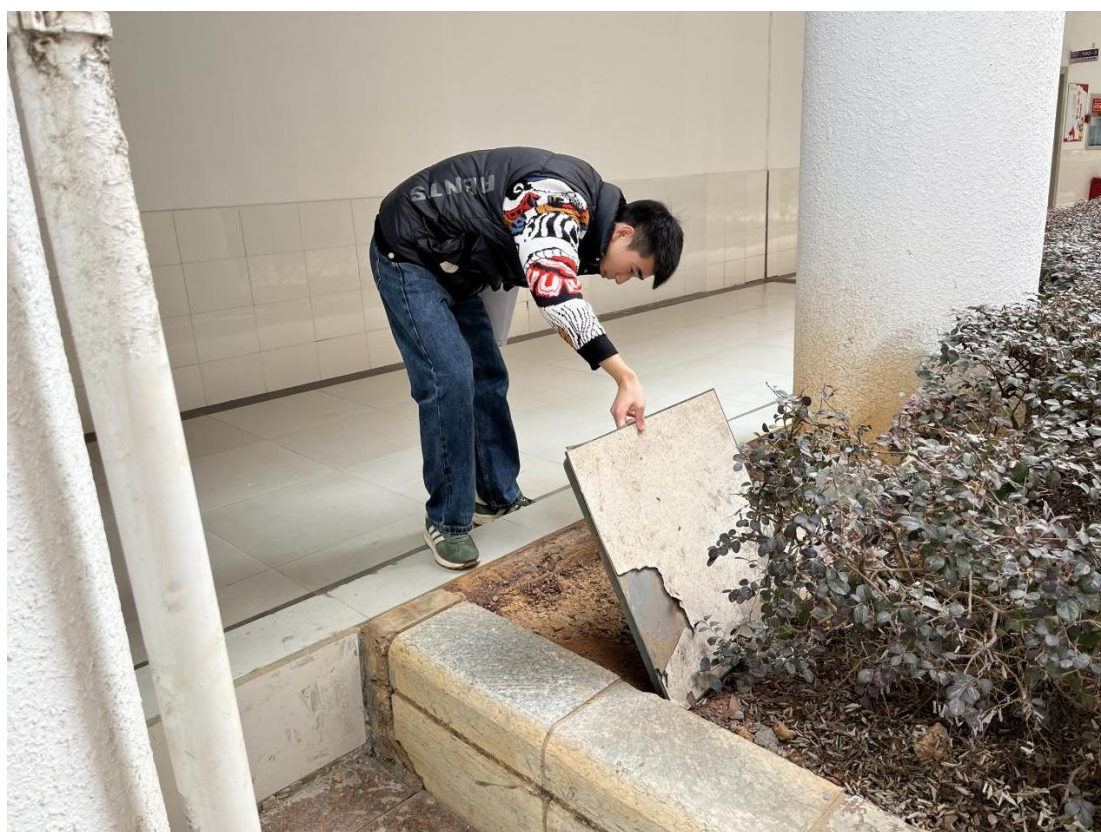
统计学校各项基础建设相关设施设备的损坏情况
