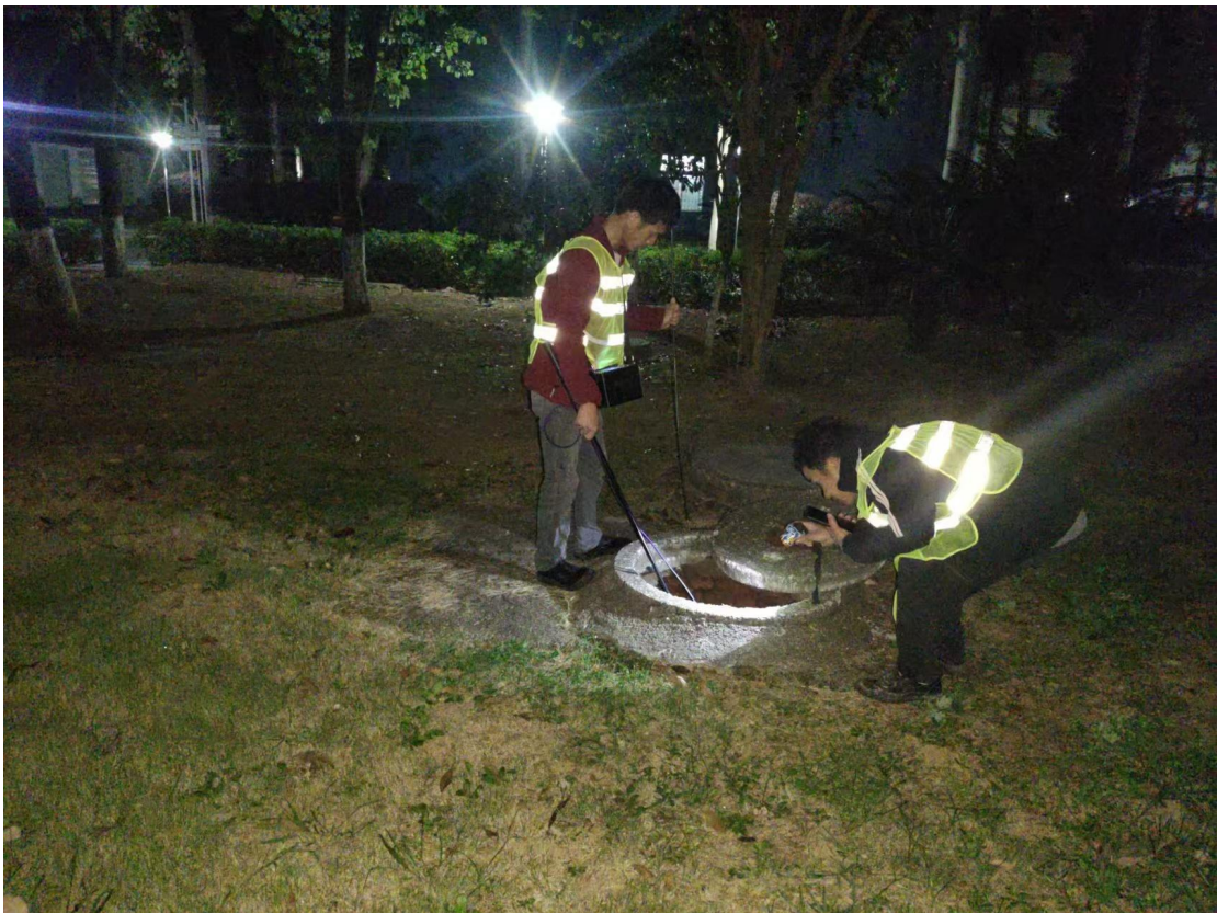
邀请广西全辉机电工程有限公司检测我校漏水情况
