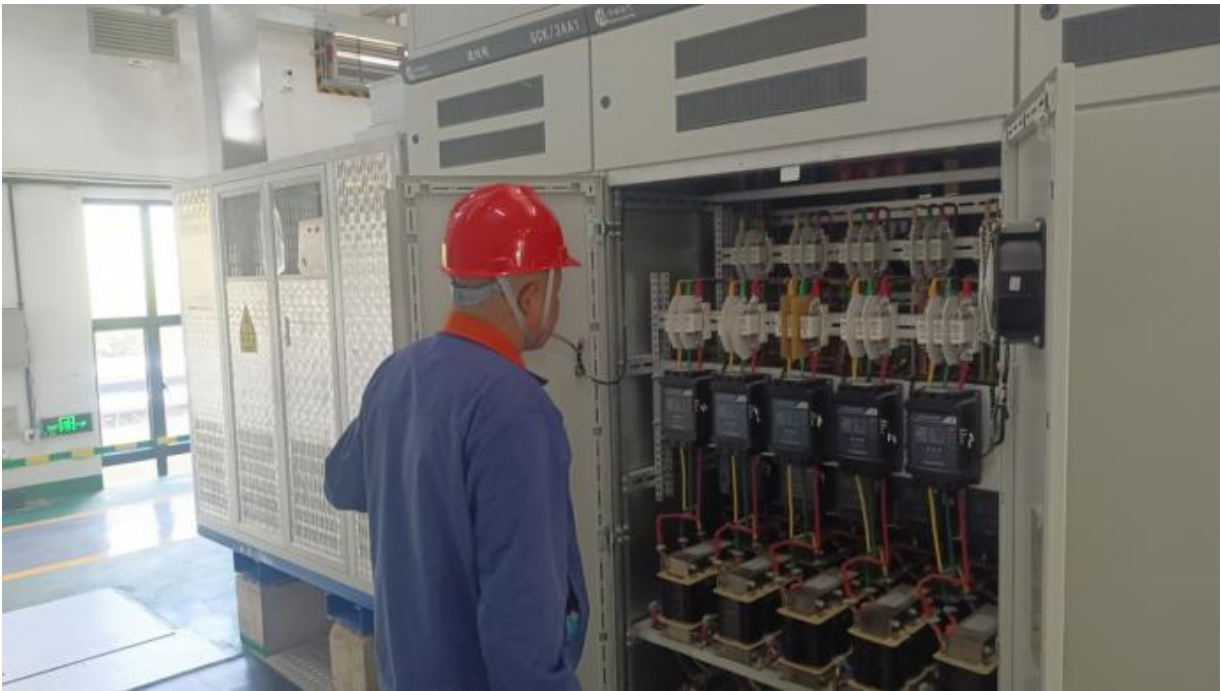
工程师傅对中心配电房进行巡检
