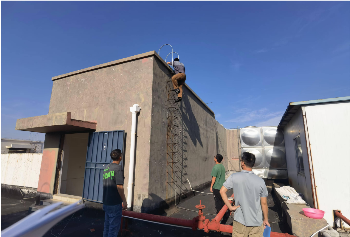
图书馆A区屋面渗水现场勘察
