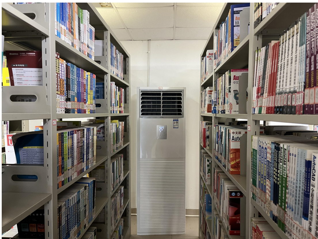
书库安装空调后
