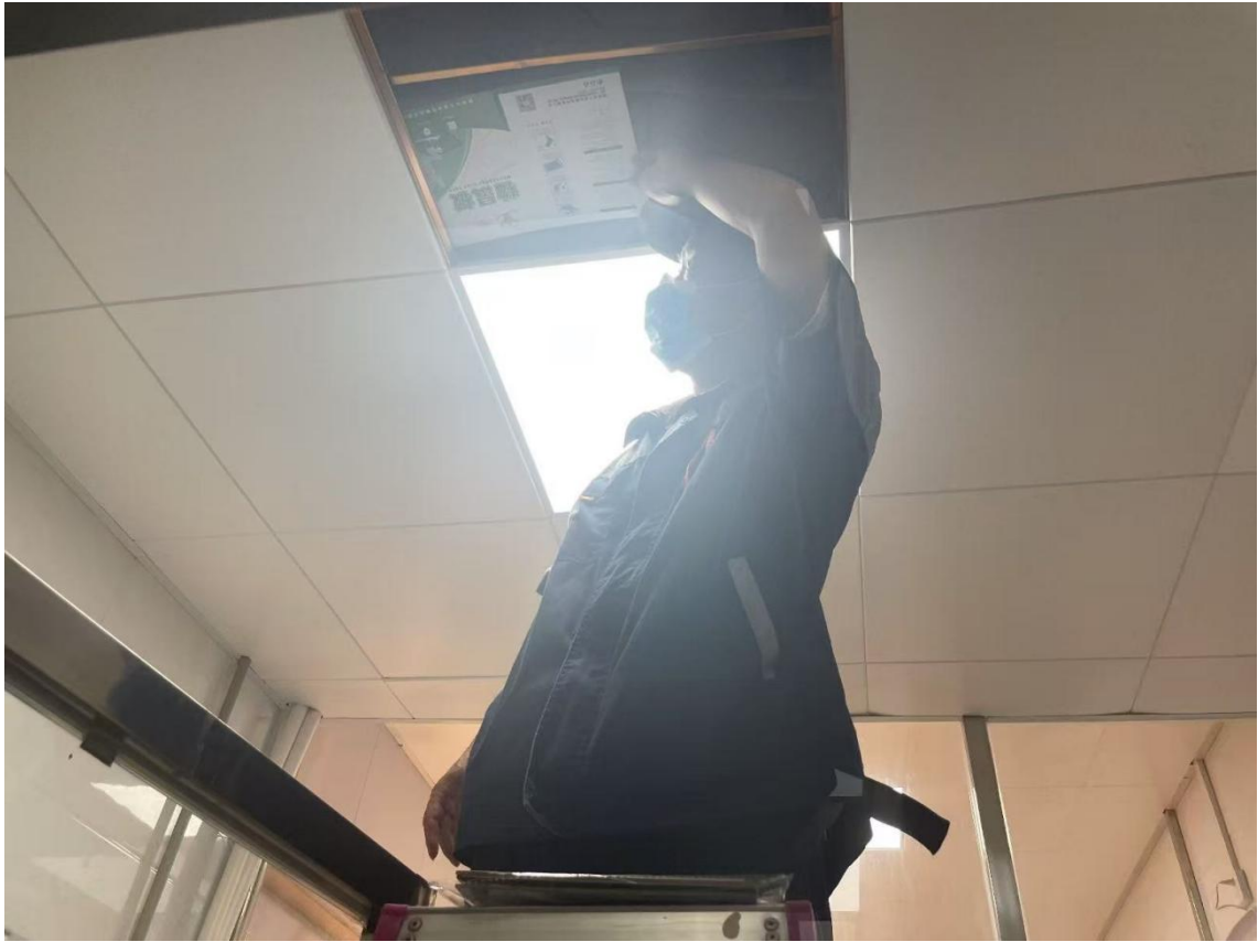
东城燃气公司对二食堂燃气系统展开检查工作
