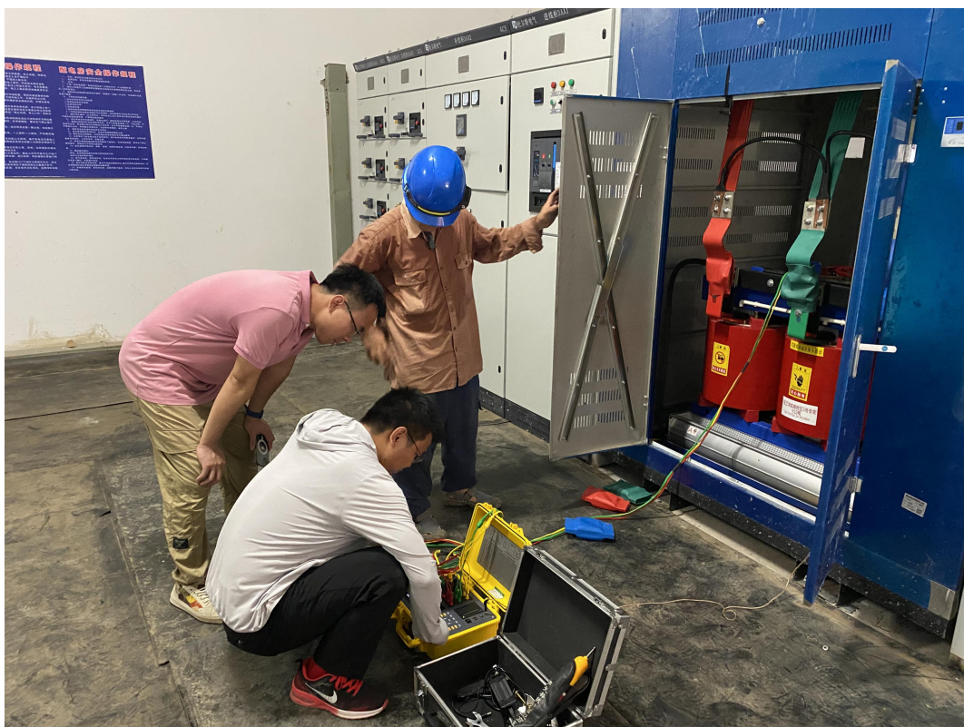
新增的空调变压器在投入使用30日后进行测试
