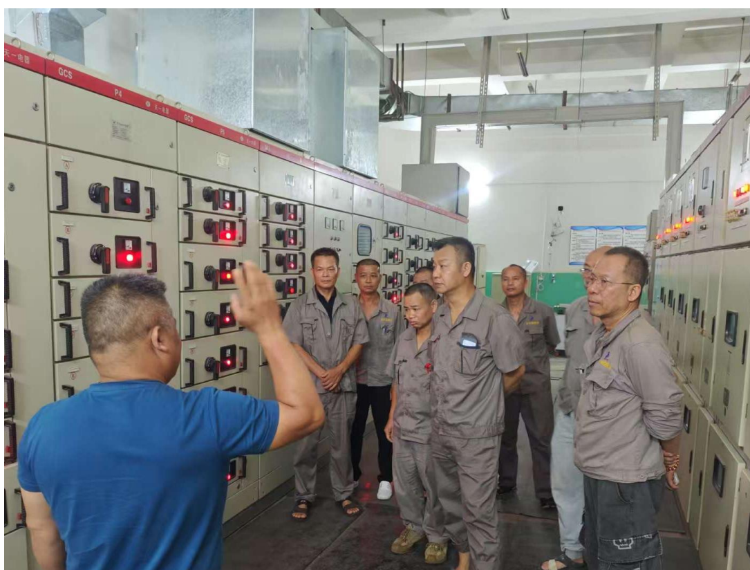
对物业工程、水电维修人员开展培训会议
