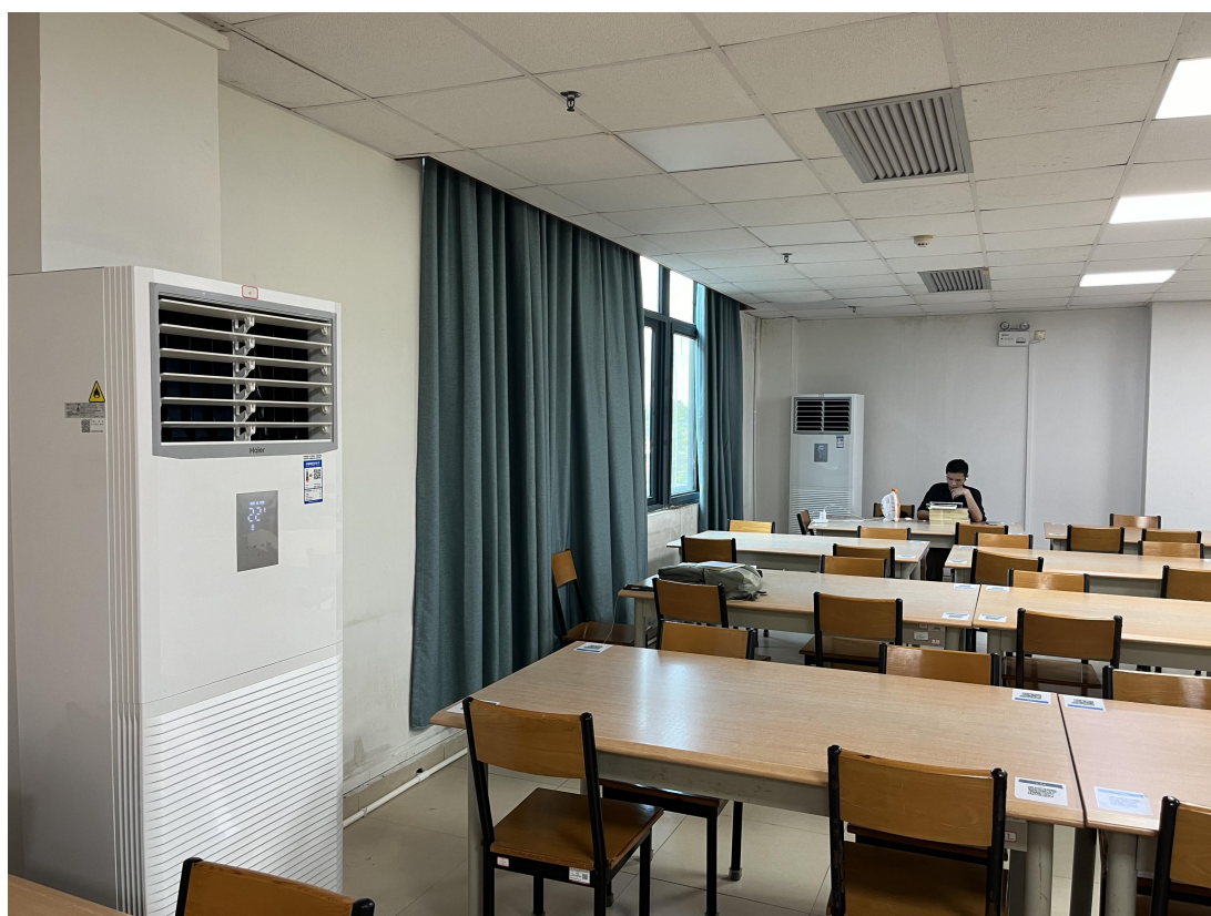
教学区安装空调后
